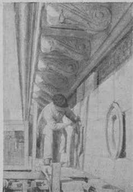
Процесс монтажа цементных деталей на строительстве жилых домов по ул. Горького в Москве
